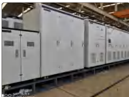
船舶岸基供电系统
