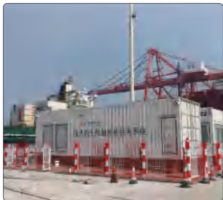
船舶岸基供电系统
