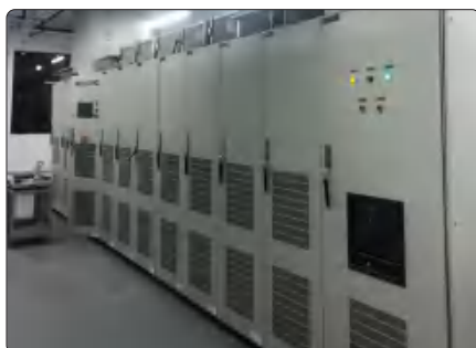
船舶岸基供电系统
