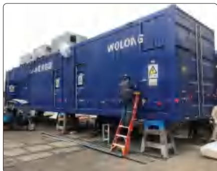
船舶岸基供电系统
