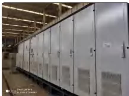
船舶岸基供电系统
