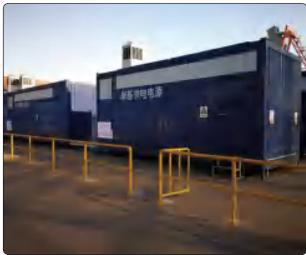
船舶岸基供电系统
