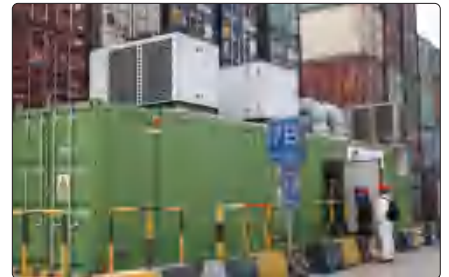
SCT 船舶岸基供电系统
