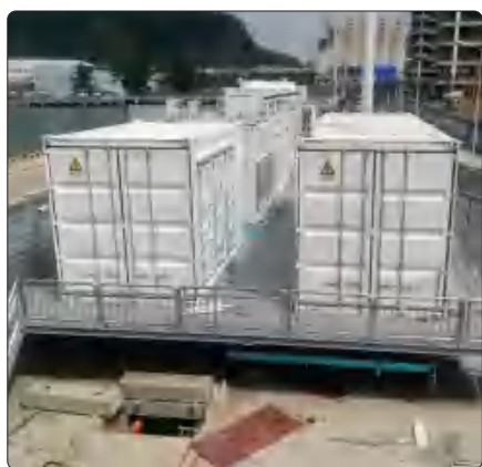
邮轮船舶岸基供电系统
